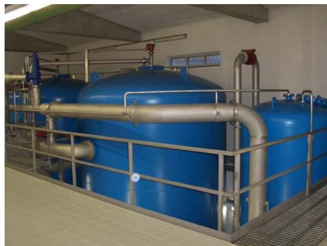
Bild: Die Filtration im Wasserwerk Erding
