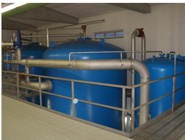
Bild: Die Filtration im Wasserwerk Erding
